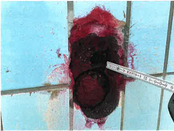
Bild A 5: Karbonatisierung bei BM 4
