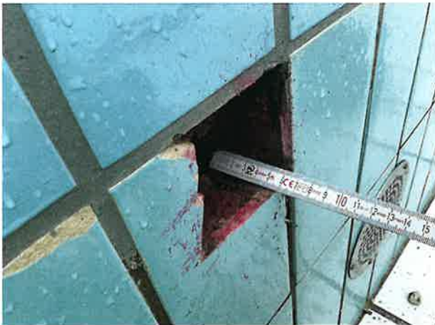
Bild A 3: Karbonatisierung bei BM 2
