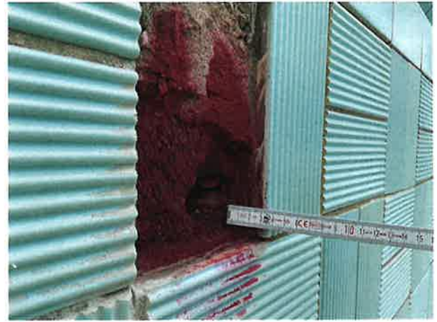
Bild A 6: Karbonatisierung bei BM 5
