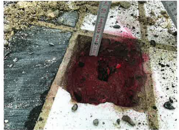
Bild A 4: Karbonatisierung bei BM 3
