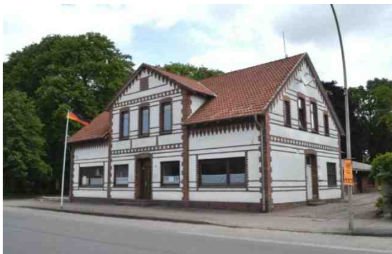
Alter Schützenhof mit typischer Tonziegeleindeckung - ortsgerechte Dach- und Fassaden-sanierung erforderlich!
